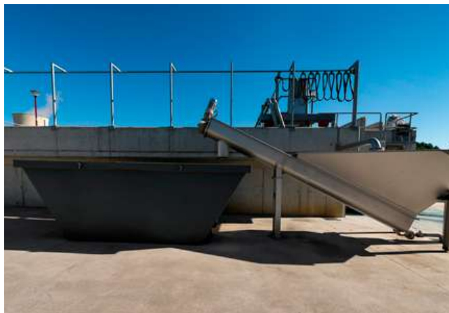
Separador de arenas (EDAR)
