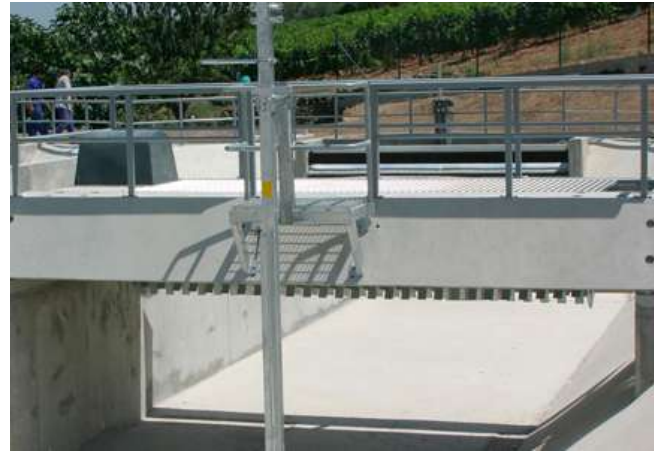
Rotores de aireación (EDAR)
